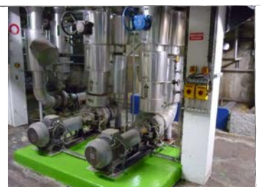
Chaufferie Malakoff Nantes
